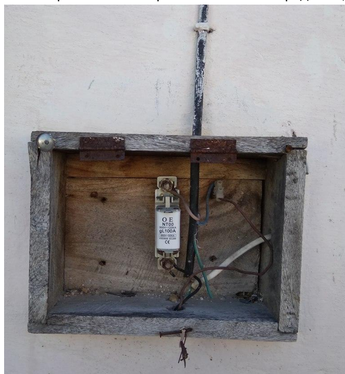
Вводно – распределительное устройство. IP-00
